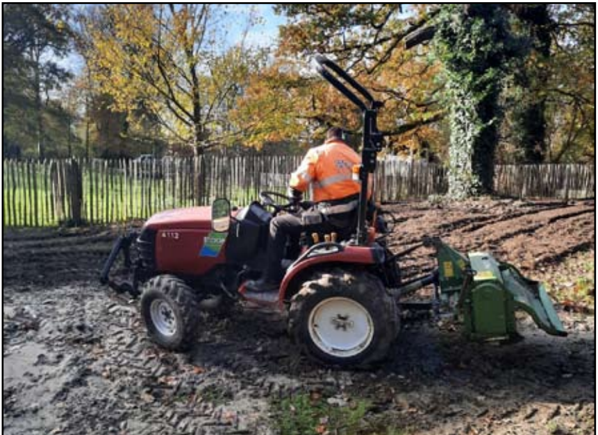
Het gehele terrein wordt gefreesd ten behoeve van het zaaien en planten.
