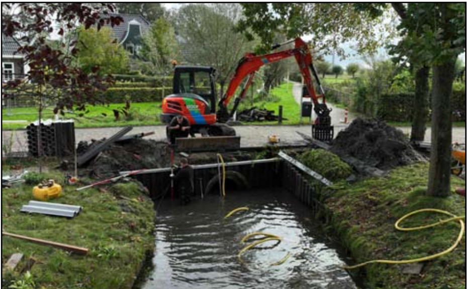
Een hardhouten damwand wordt bij de duiker vervangen voor een kunststof damwand.
